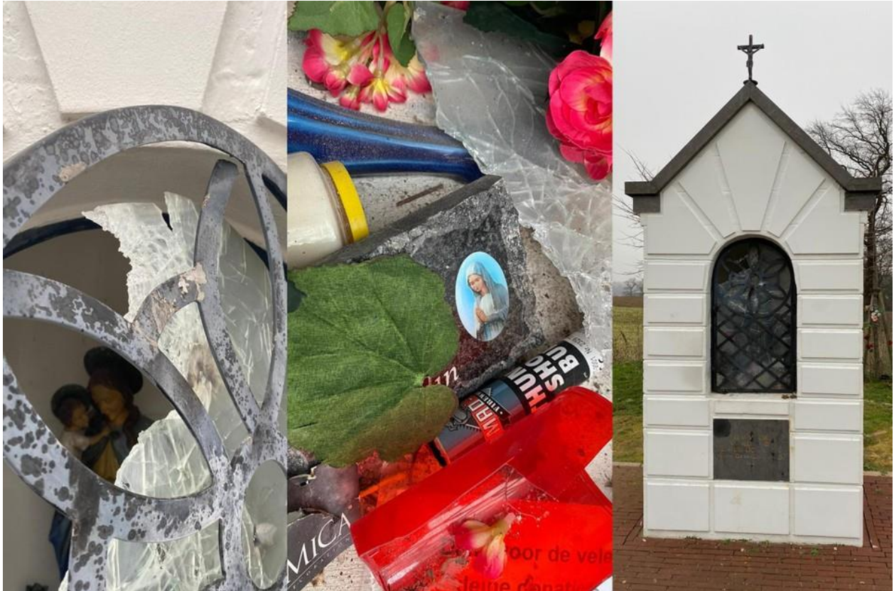
Schade aan de kapel door een vuurwerkbom in januari 2020. – © Catharinagilde
